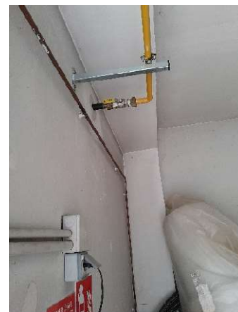
Alimentation générale de gaz, dans le local chaufferie, à côté de la porte derrière la cuisine, face à la médiathèque. Abaisser la poignée jaune
