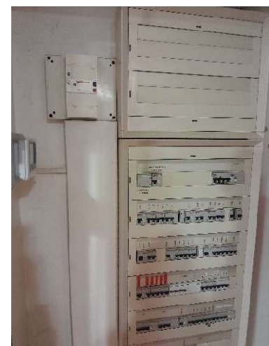
Alimentation d'électricité générale. Abaisser le bouton « arrêt d'urgence commande »
