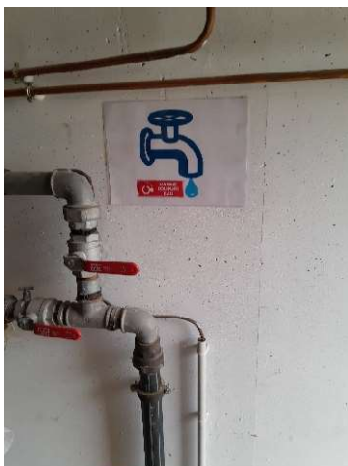
Alimentation d'eau générale, dans le local chaufferie, à côté de la porte derrière la cuisine, face à la médiathèque. Abaisser la poignée
