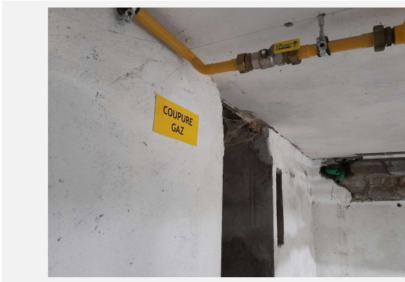
Alimentation gaz générale dans le local chaufferie (sous-sol face au portail de l'école). Fermeture en abaissant la poignée
