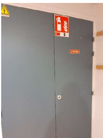
Placard du tableau électrique, dans le couloir à côté de la tisanerie. Utiliser n'importe quelle clé pour l'ouvrir
