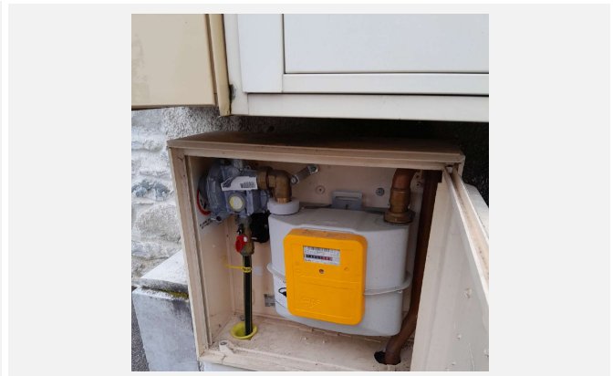
Vue de la vanne principale de gaz face à l'abri bus à côté du portail de l'école. Ouvrir le boîtier avec n'importe quelle clé et tourner la poignée rouge
